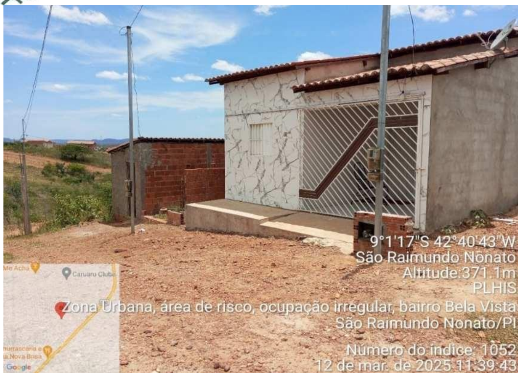
Foto 27 - Casa construída em área de risco e ocupação irregular, no bairro Bela Vista/01. Fonte: Autores do PLHIS (2025).
