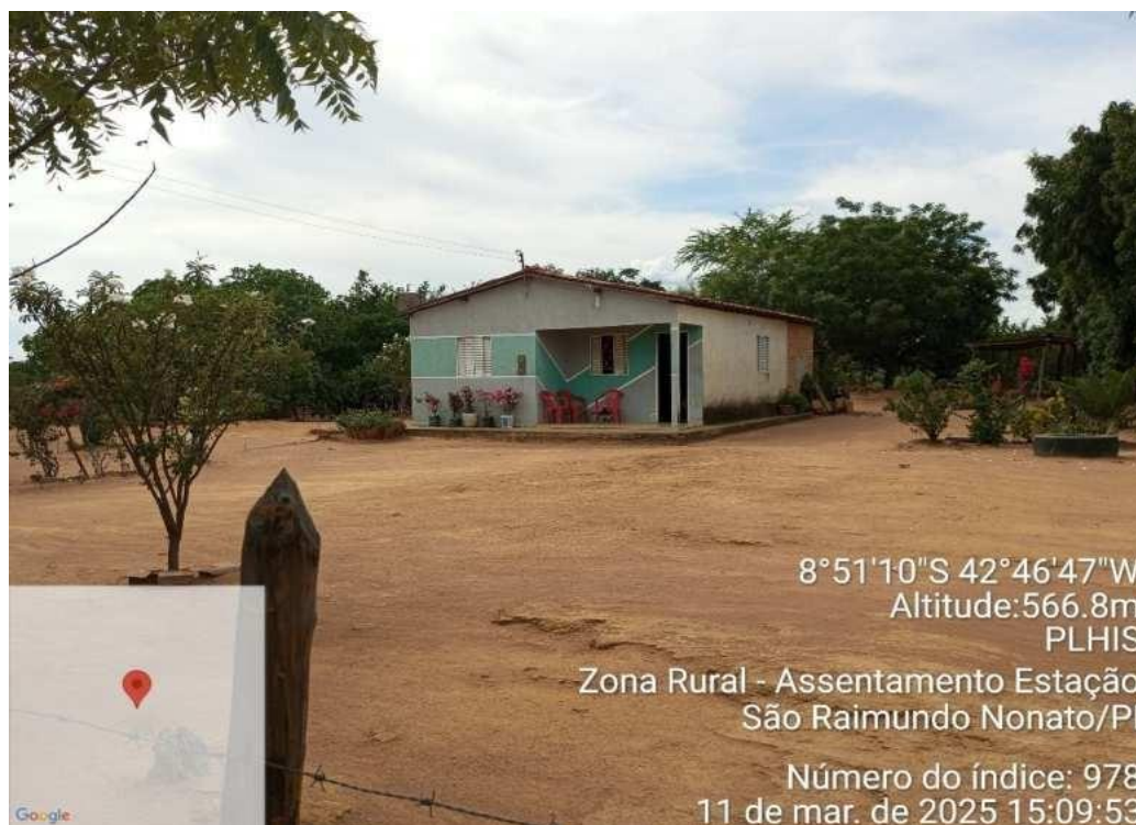
Foto 54 - Habitação precária no Assentamento Estação/02. Fonte: Autores do PLHIS (2025).
