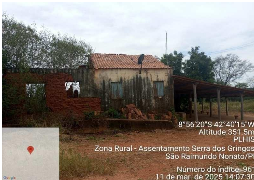
Foto 44 - Residência precária no Assentamento Serra dos Gringos/02. Fonte: Autores do PLHIS (2025).
