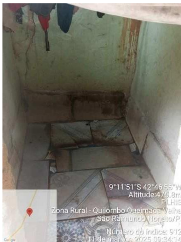
Foto 91 - Banheiro residencial no quilombo Queimada Velha, com ausência de dispositivos sanitários adequados.
