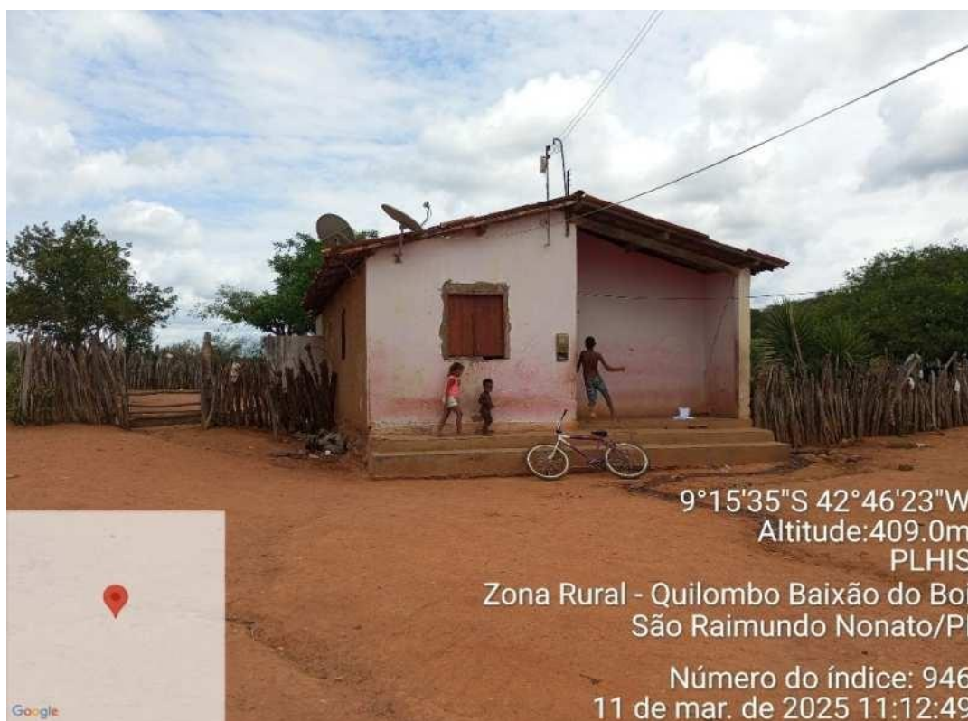
Foto 87 - Domicílio rústico com adensamento excessivo no Quilombo Baixão do Boi. Fonte: Autores do PLHIS (2025).
